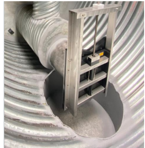
Vanne de confinement (ouvrage 100% D9A)
