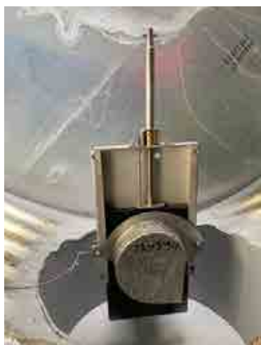
Vanne de confinement avec régulation de débit (ouvrage mixte)
