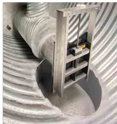
Vanne de confinement (ouvrage 100% D9A)
